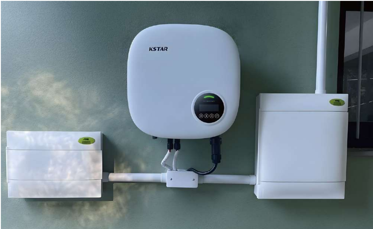
11 Residentieel Zonne-energieproject in Brazilië
